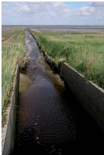
St. 905, udløbet mod havet.
