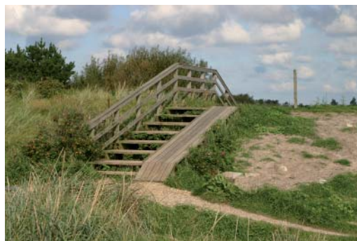
Gangtrappe set fra syd. Græslandet på forskråningen er kraftigt beskadiget.
