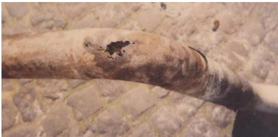
Figur 4.5 Foto fra 1990 af utæt rør, tank 18.
