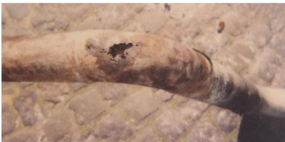
Figur 6.5 Foto fra 1990 af utæt rør, tank 18.
