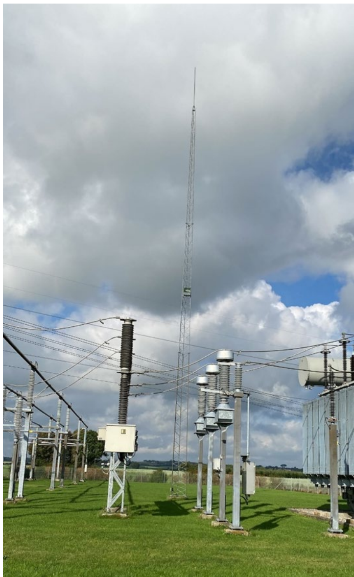
Figur 6-2. Eksempel på lynfangsmast. I forgrunden komponenter i et transformervek. Transformer ses til højre. Samleskinne ses til venstre.
