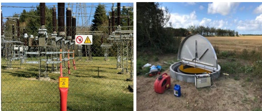
Figur 2-17 Eksempelfoto af markeringspæl og linkboksbrønd
