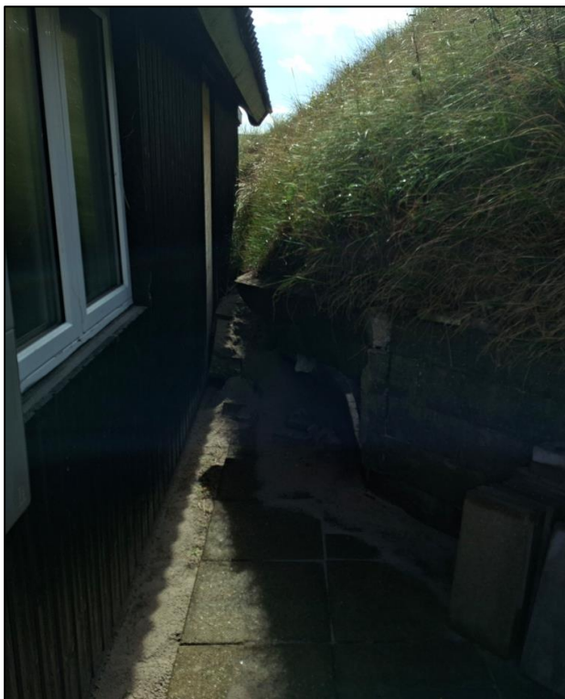
Fig. 6. Billede taget på besigtigelse af ejendommen den 9. september 2026. På billedet kan man se den væltede støttemur bag sommerhuset.
