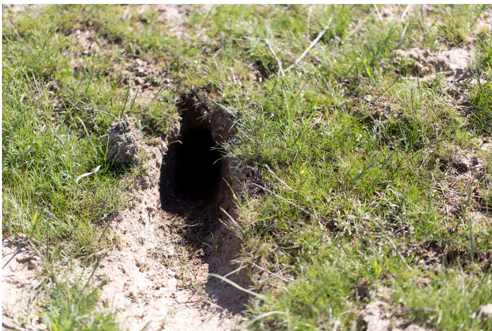
Fig. 2.5 Rævegrave kan forvolde stor skade på diget. Når ræven bygger, vil den ofte grave sig hele vejen igennem diget, så den har flere udgange fra hulen.
