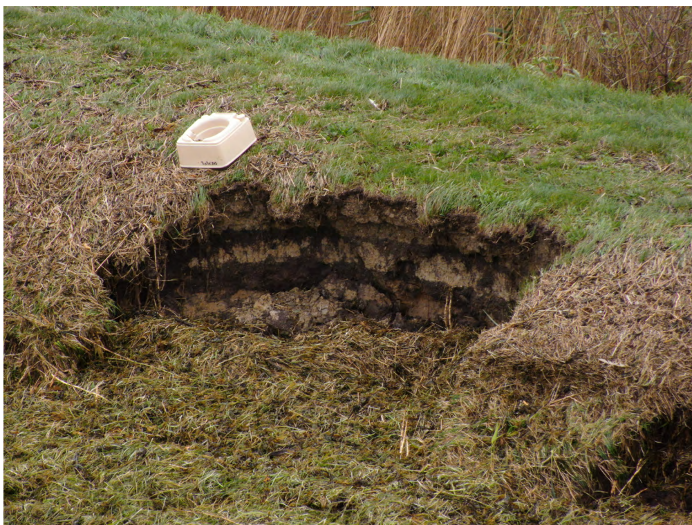
Fig. 1.2.2 En storm med hård bølgepåvirkning har revet hul i diget.
