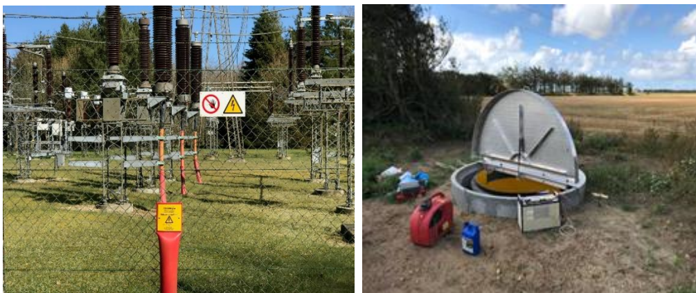
Figur 2-16 Eksempelfoto af markeringspæl og linkboksbrønd
