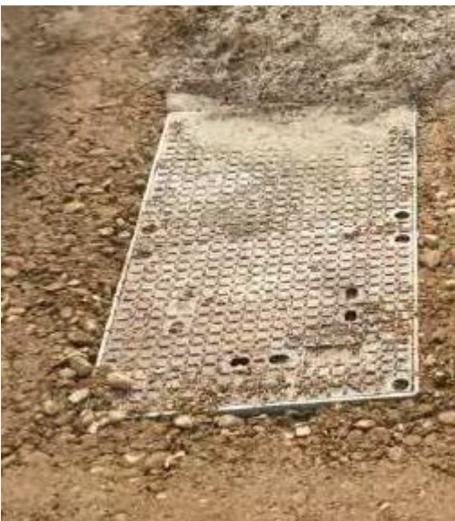
Figur 2-3 Eksempel på fiberbrønd i terræn
