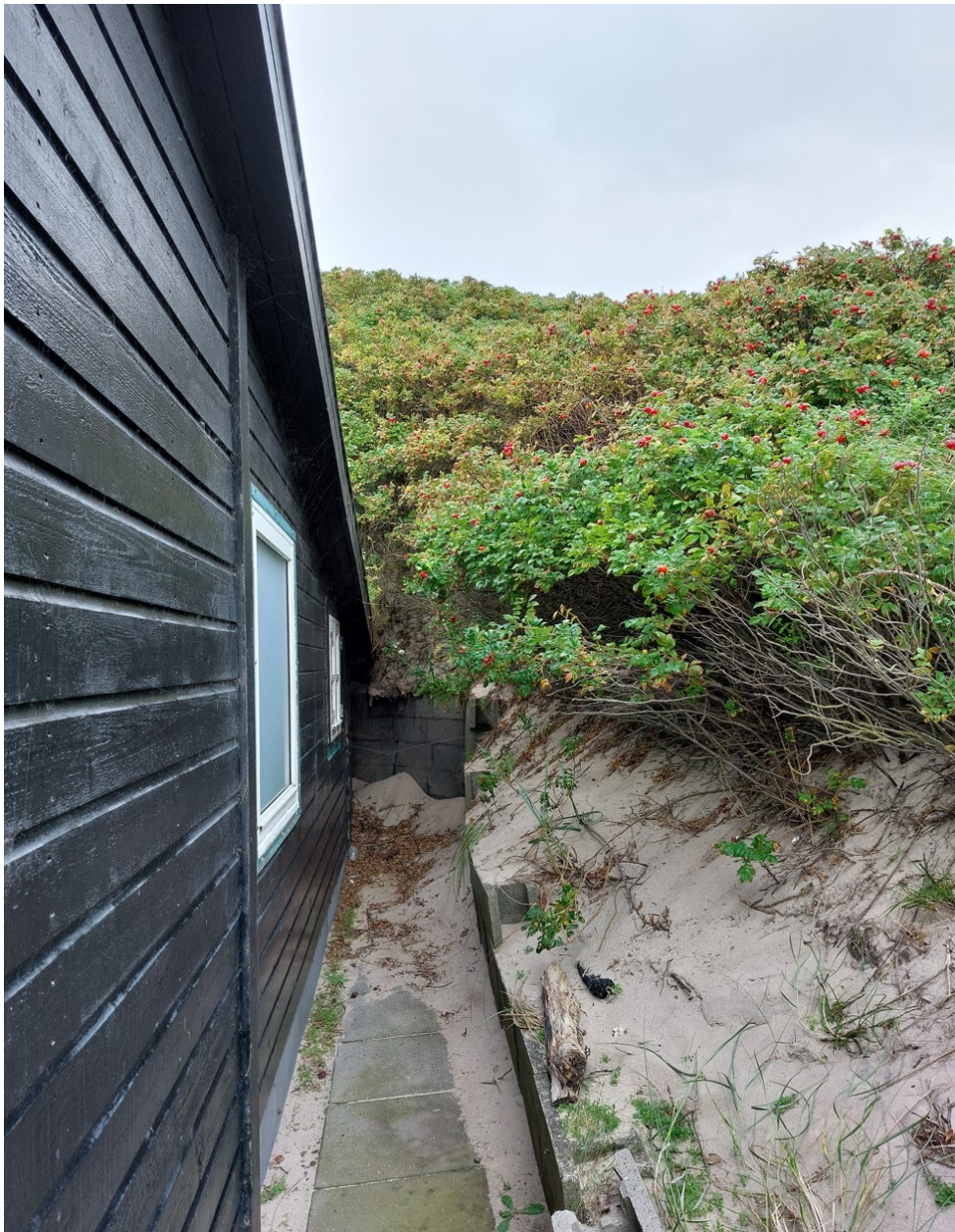
Fig. 7. Billede taget på besigtigelse af ejendommene d. 16-09-2024. På figuren ses et billede fra Bjerghuse 60, hvor man kan se at klitten er vokset meget højt op langs ejendommen.
