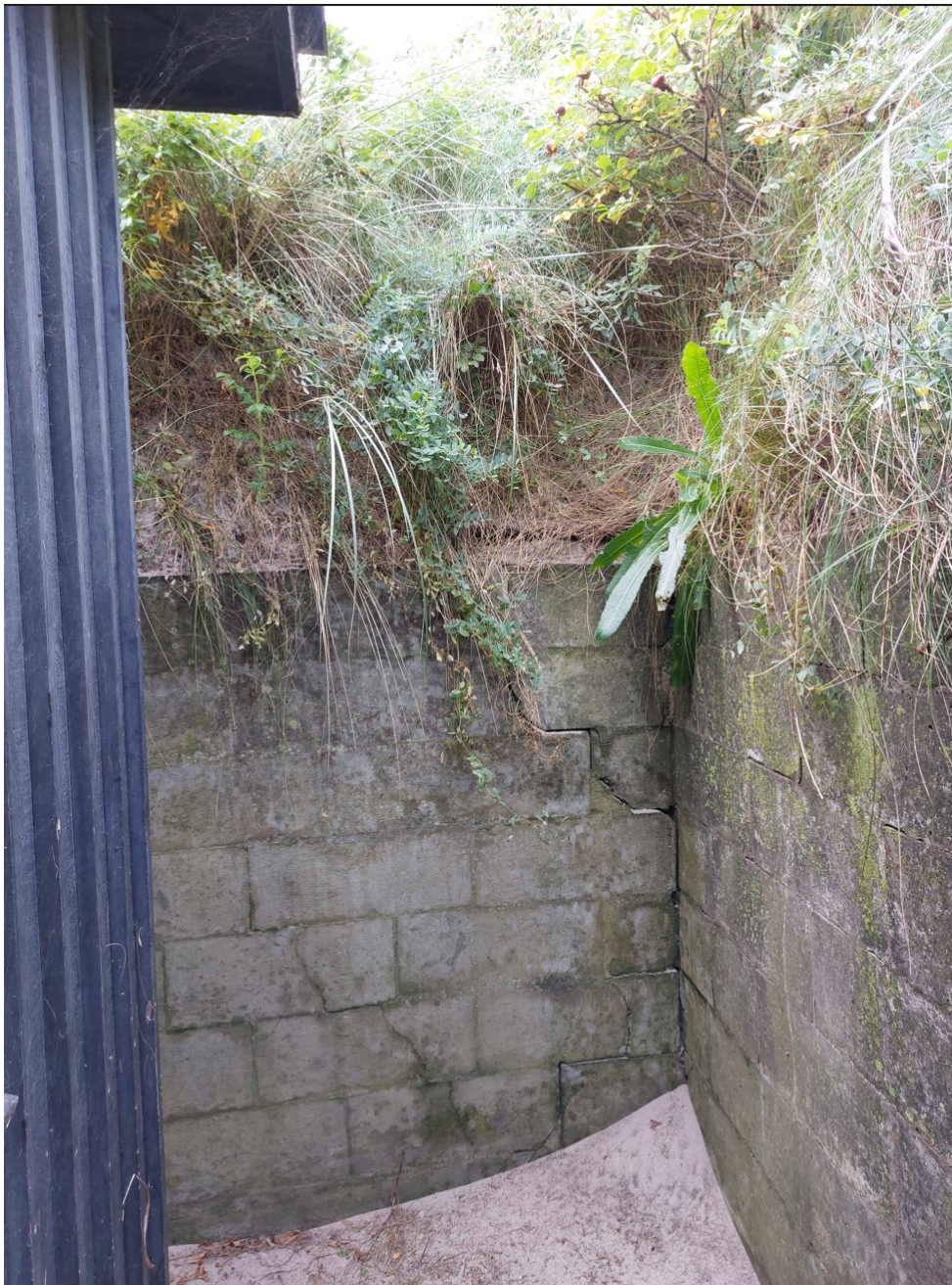
Fig. 4. Billede taget på besigtigelse af ejendommene d. 16-09-2024. På figuren ses et billede fra Bjerghuse 61, hvor man kan se at presset fra sandet har fået støttemuren til at revne.
