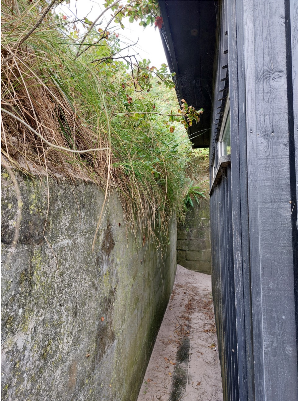
Fig. 3. Billede taget på besigtigelse af ejendommene d. 16-09-2024. På figuren ses et billede fra Bjerghuse 61, hvor man kan se at presset fra sandet har presset støttemuren, så den tilter ind mod sommerhuset.
