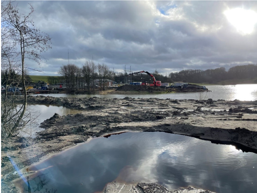
Sø med tydelig misfarvning og afløb til opsamlingsbassin til forurenet overfladevand
