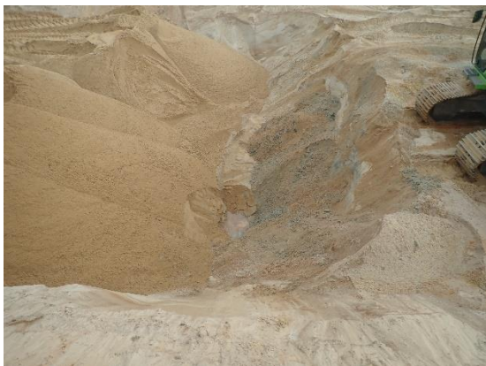
#13 Bund af udgravning ved 3.15, sydlig del af rende, set fra vest.
