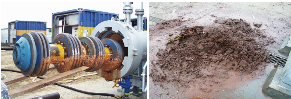
Figur 1 Til venstre ses korrosionsslam opsamlet af rensegrisen, der tages ud af røret. Til højre ses partikulært materiale i form af jordpartikler, svejseslagger og korrosionsslam, der er skubbet ud foran grisen ved rensning af røret.
