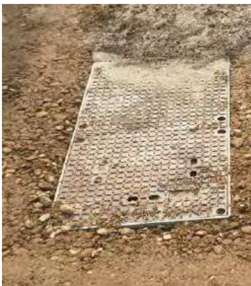
Figur 2-3 Eksempel på fiberbrønd i terræn
