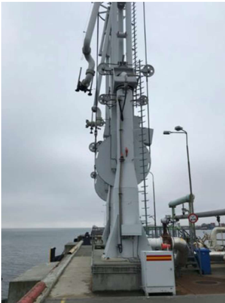
Figur 11: Eksempel på en typisk lastearm på et kajanlæg.
