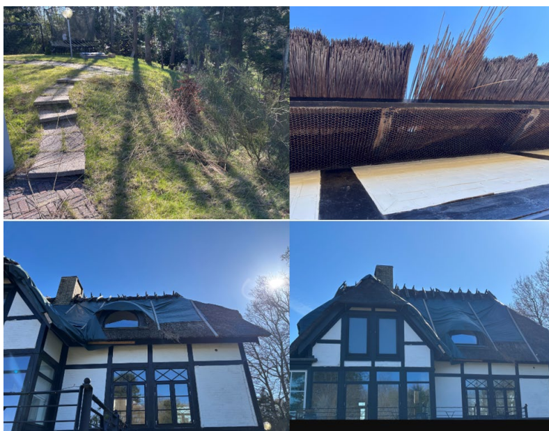
Fig. 2. Fotos af ejendommens hus indsendt af ejer, hvorpå det ødelagte tag kan ses.
