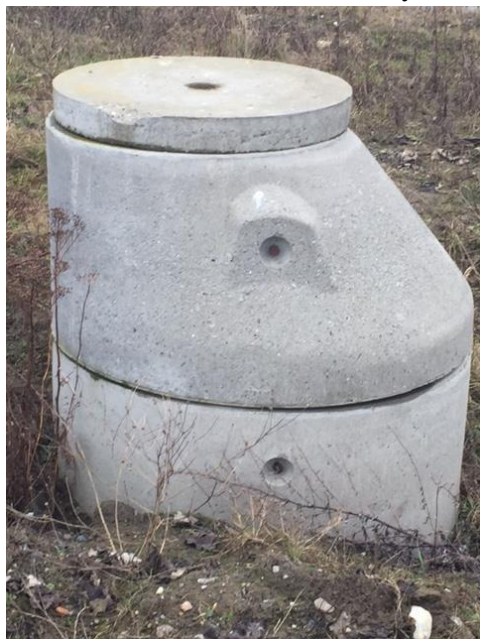
Billede 11.1: Spulebrønd monteret med betondæksel
