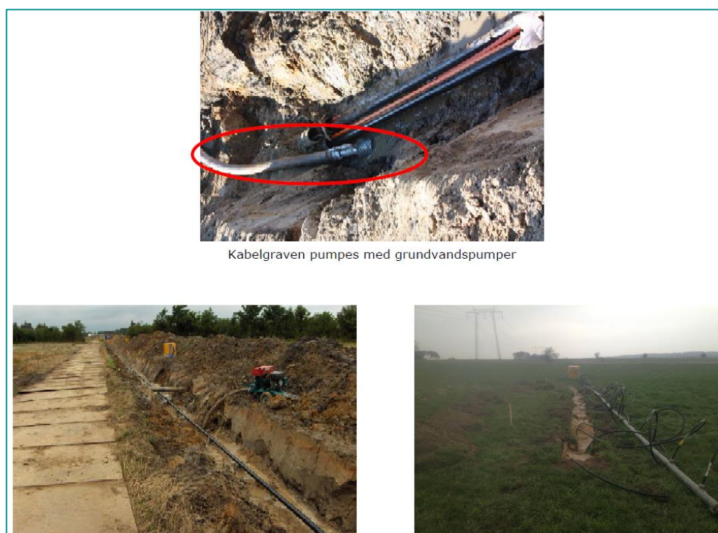
Figur 2-8 Forskellige metoder til at holde kabelgraven tør. På billedet til venstre etableres drænrør, til højre etableres sugespidsanlæg
