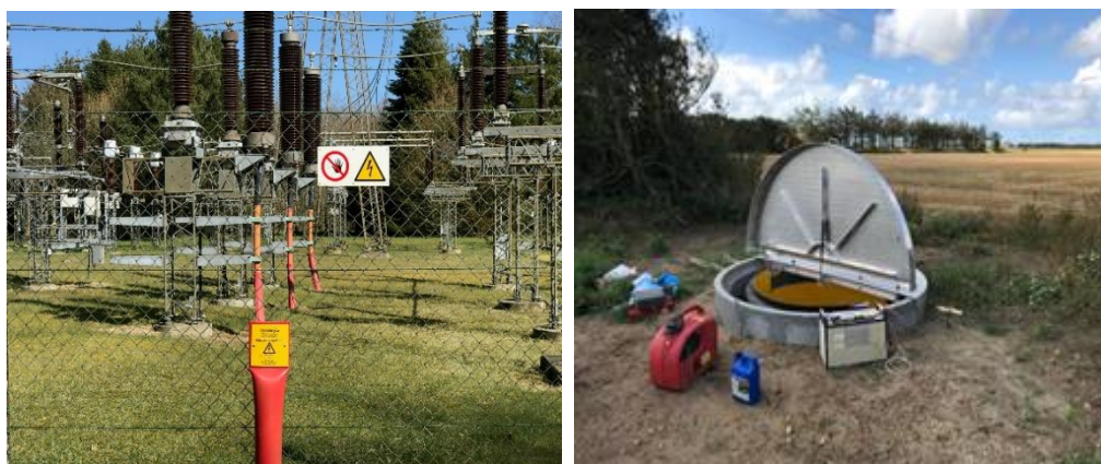
Figur 2-16 Eksempelfoto af markeringspæl og linkboksbrønd
