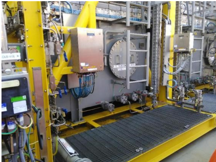
Stationære tank til H 2 S scavenger
