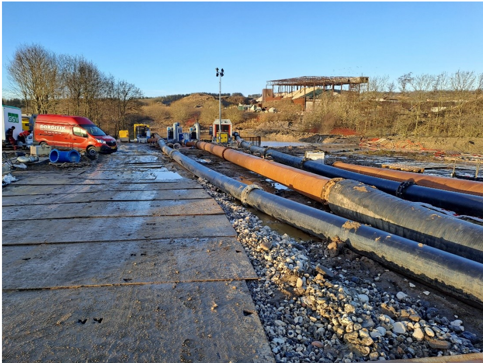
3 af de nuværende trykledninger for rent vand set fra landevejen med transformerstationen til venstre
