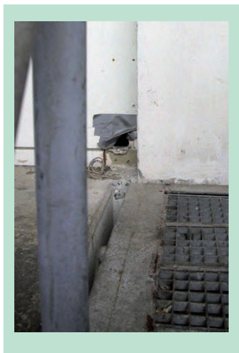
FIGUR 23. Et usikret hul fra en tidligere rør-gennemføring er en klassisk indfaldsvej for rotter og mus på en virksomhed.
