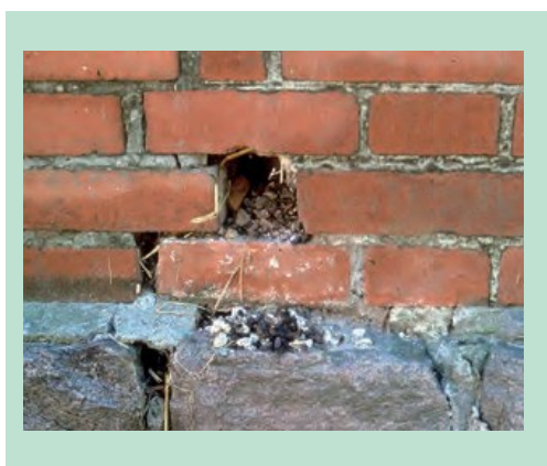
FIGUR 25. Alle huller i fødevarevirksomhedens ydervæge og fundament skal lukkes forsvarligt, f.eks. med galvaniseret trådnet og beton.
