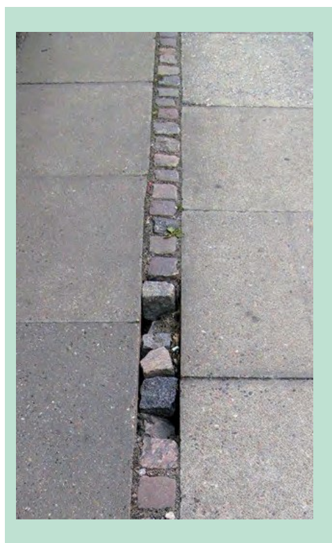
FIGUR 20. Sætningsskader udendørs på virksomheden betyder som regel rotteaktivitet.
