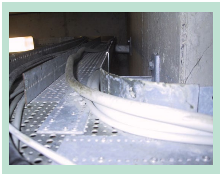
FIGUR 33. De brune belægninger på ledningerne viser, at rotterne benytter kabelbakkerne som transportvej
