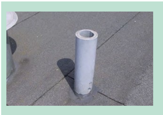
FIGUR 29. Faldstammeudluftning uden net. Sådanne udluftninger kan ofte være anledning til rotteangreb på fødevarevirksomheder.
