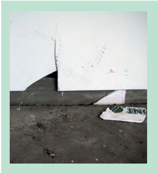
FIGUR 2. Ituslået ydervæg i fødevarer virksomhed. Virksomhedens egenkontrolprogram skal bl.a. anføre, hvordan virksomhedens bygninger løbende vedligeholdes
