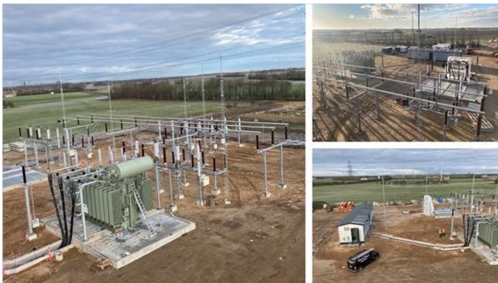
Figur 2.4 Eksempel på delvis åben transformerstation
