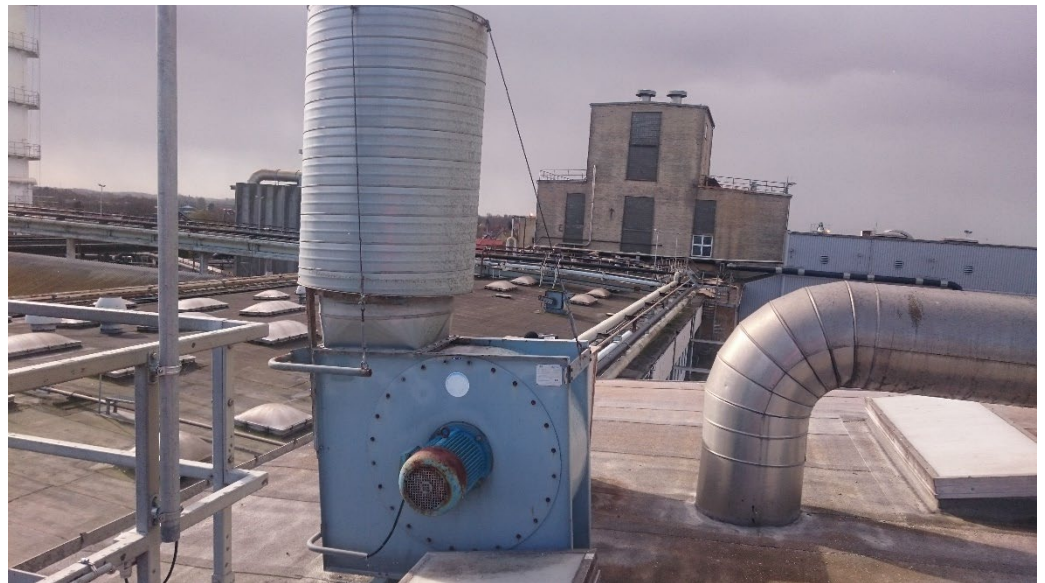
Figur 6 Lyddæmper placeret på afkastet af en ventilator.
