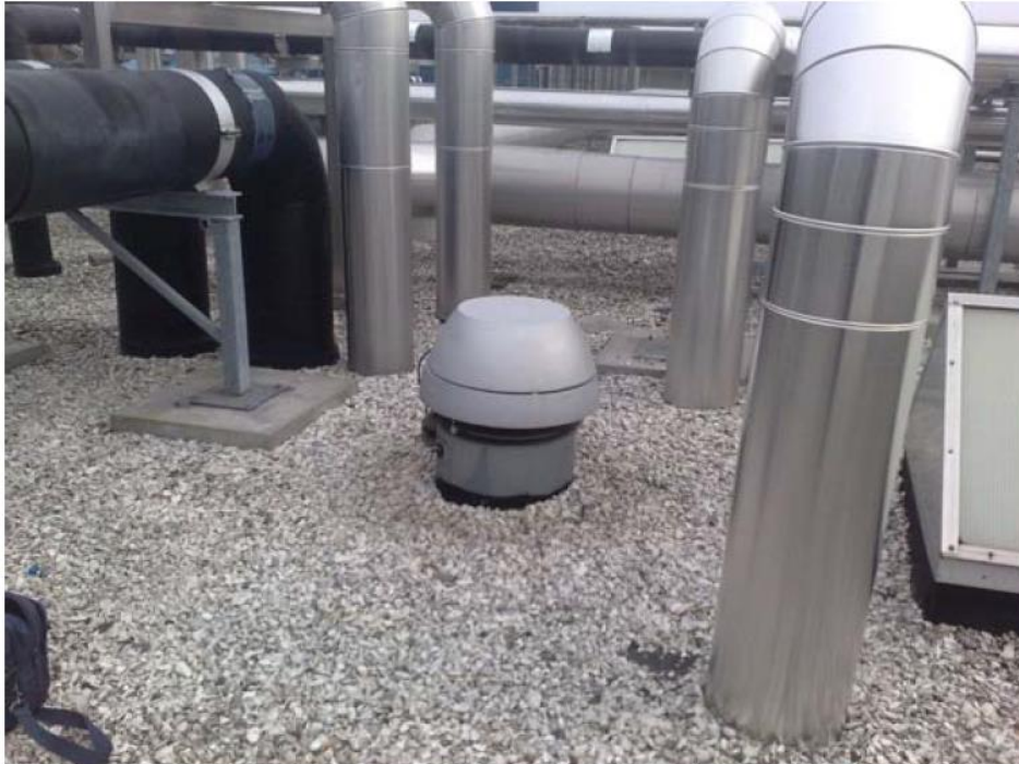
Kilde 7337 - Udsug fordelerrum 1. sal.
