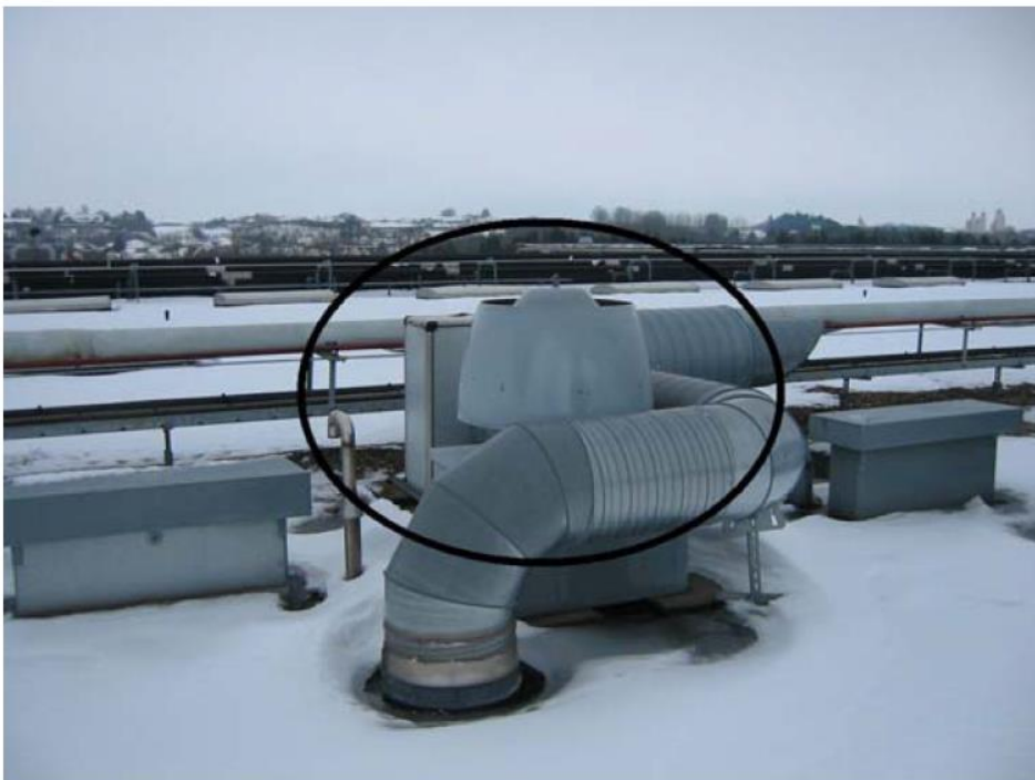
Kilde 8330 - Afkast luft komp. ingeniørgang
