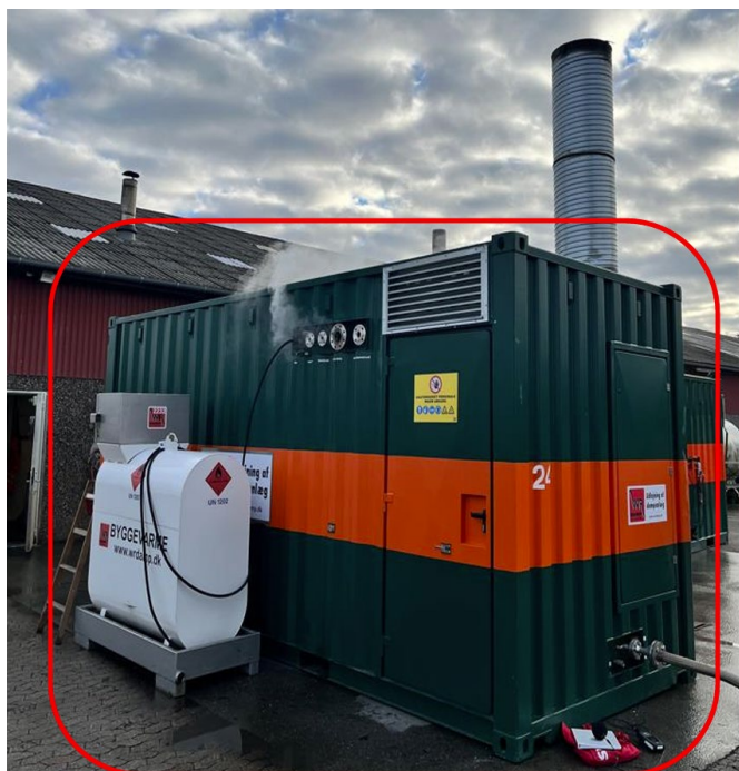
Figur 2 Foto af tilsvarende dampkedel med skorsten. I projektet anvendes en anden løsning for olietank end vist på dette foto, hvor olietanken placeres i sin egen 20 fods container i umiddelbar nærhed af de to dampkedel-containere.
