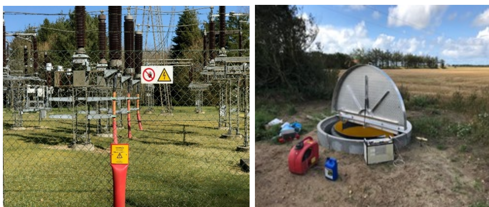
Figur 2-66 Eksempelfoto af markeringspæl og linkboksbrønd
