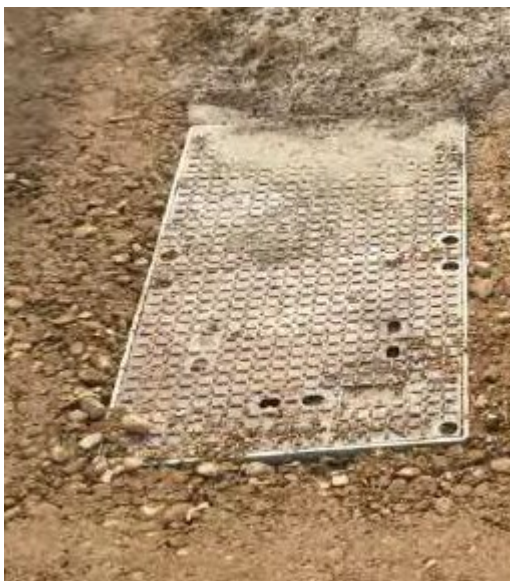
Figur 2-3 Eksempel på fiberbrønd i terræn
