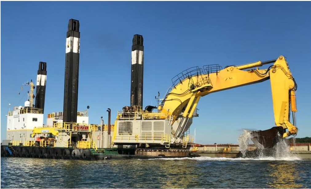
Figur 3-2: Eksempel på en gravemaskine monteret på en pram. Billedet er fra Baltic Pipe.
