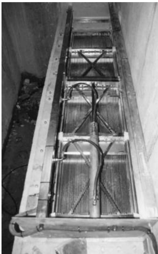
Figur 10-10 Eksempel på vandretliggende spalterist i overløbsbygværk. http://hydrosystems.dk
