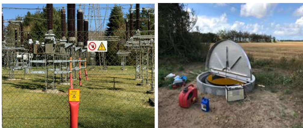
Figur 2-16 Eksempelfoto af markeringspæl og linkboksbrønd
