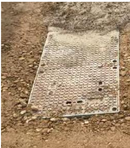
Figur 2-3 Eksempel på fiberbrønd i terræn
