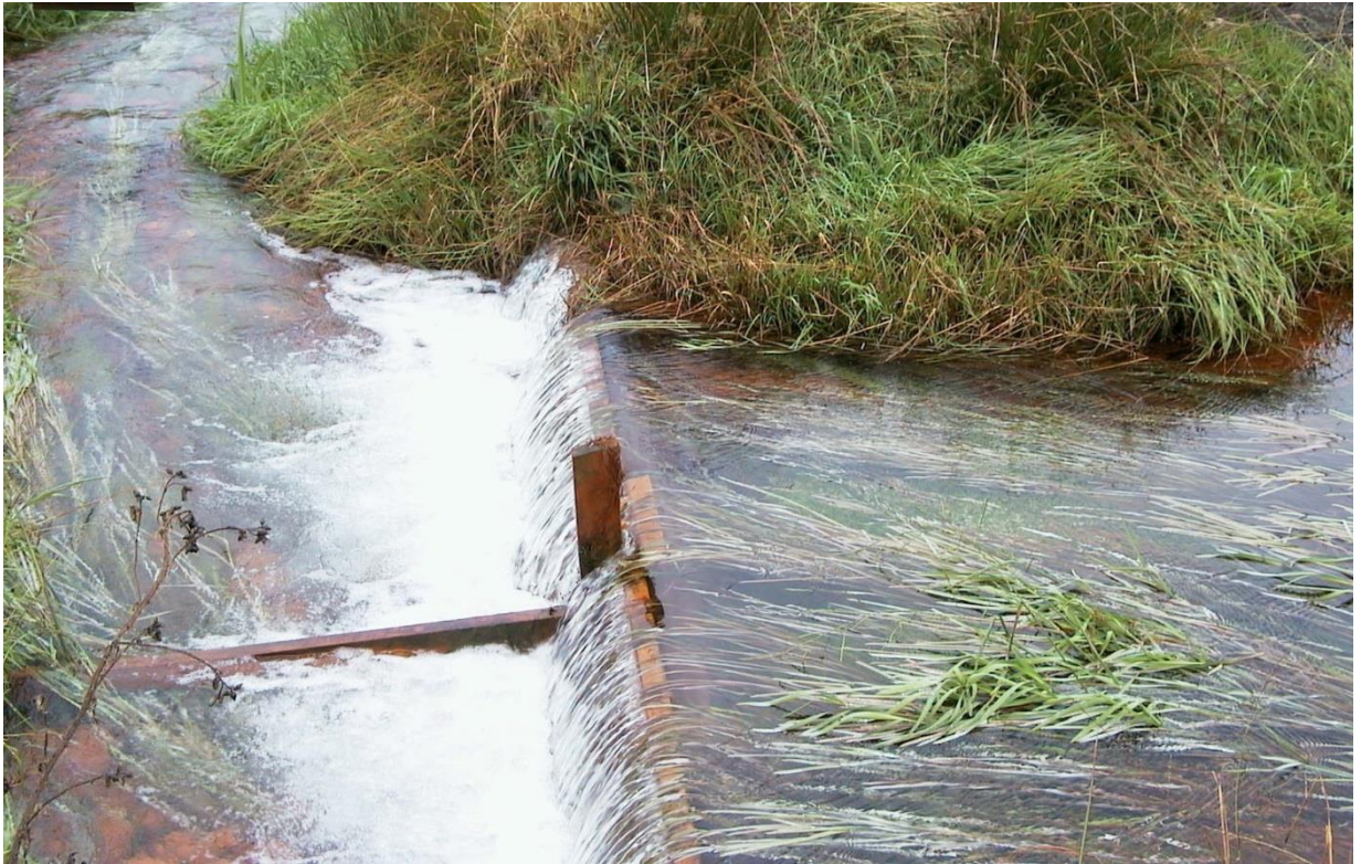
Fig. 4. Anlæg ved Hogager Bæk som viser det rene afløbsvand fra okkerrensingsanlægget. Anlægget blev etableret i løbet af vinteren 1991/92
