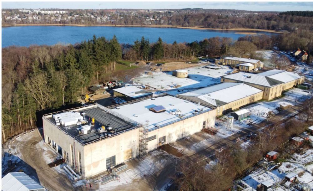
Figur 1. Værket ved Søndersø, februar 2021. I forgrunden værket, med Søndersø og Værløse i baggrunden. I den vestlige ende (nærmest) er bygningen til overfladevandsanlægget nedrevet, og en ny bygning, indeholdende filtre, iltningsanlæg og blødgøringsanlæg, er opført. Den østlige del af bygningen indeholder de oprindelige sandfiltre m.m. og er fortsat i brug, indtil den i Etape II delvist nedrives og indbygges med tankanlæg (Foto HOFOR).
