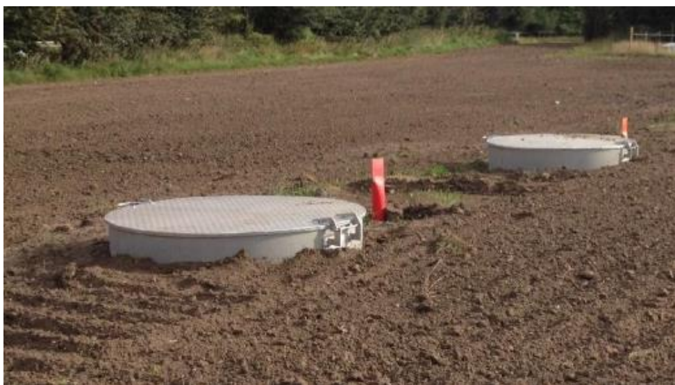
Figur 6. Eksempel fra linkboksbrønd og markeringspæle.
