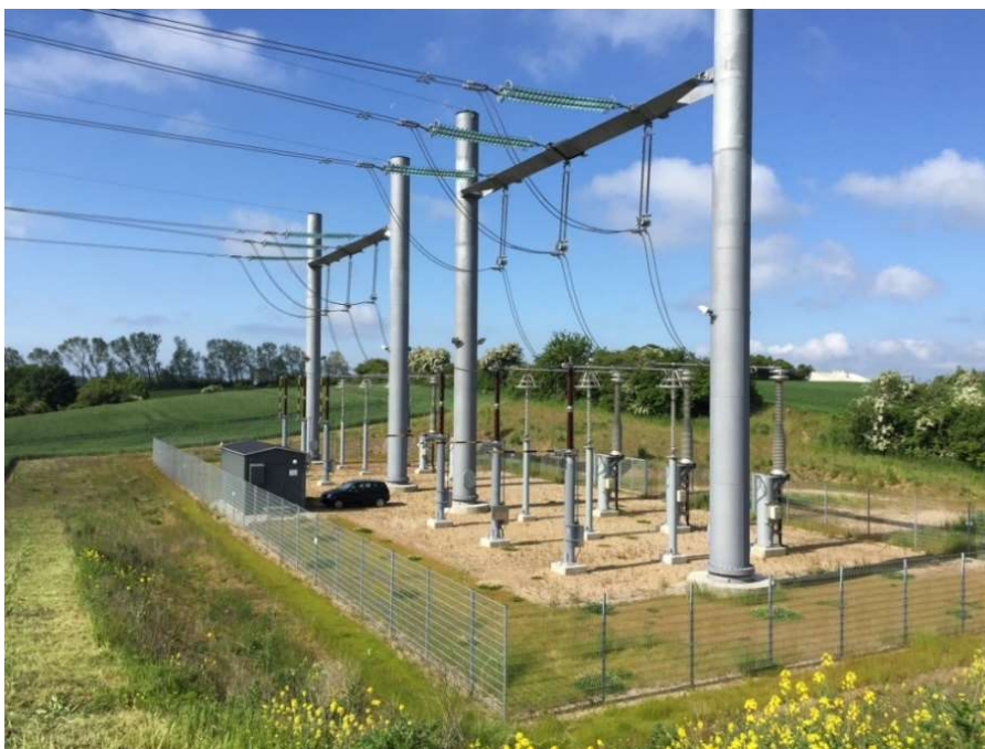
Eksempel på endetræksmaster på kabelovergang
