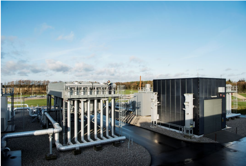
Figur 8 Kompressorbygninger og fritstående køleenhed.
