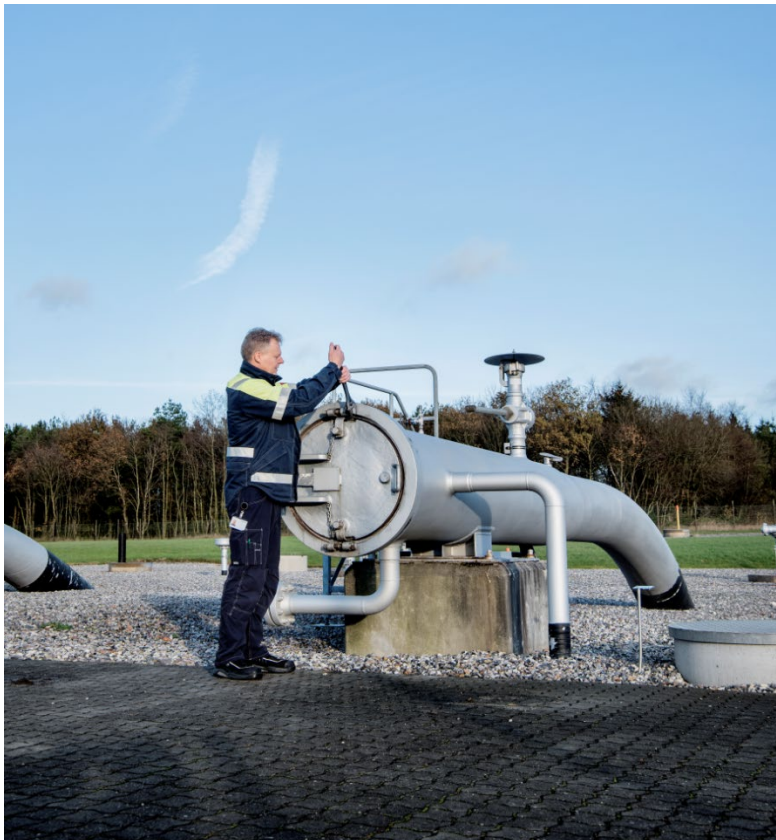
Figur 6 Scraper, der er en sluse, der bruges, når rørene skal vedligeholdes
