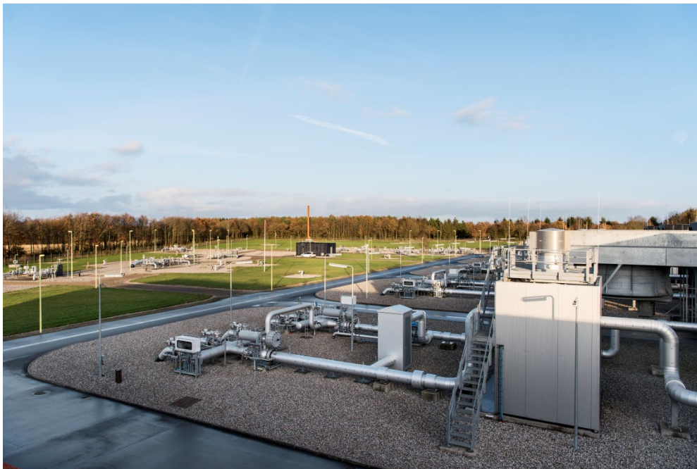
Figur 9 Røranlæg på kompressorstationen i Egtved.
