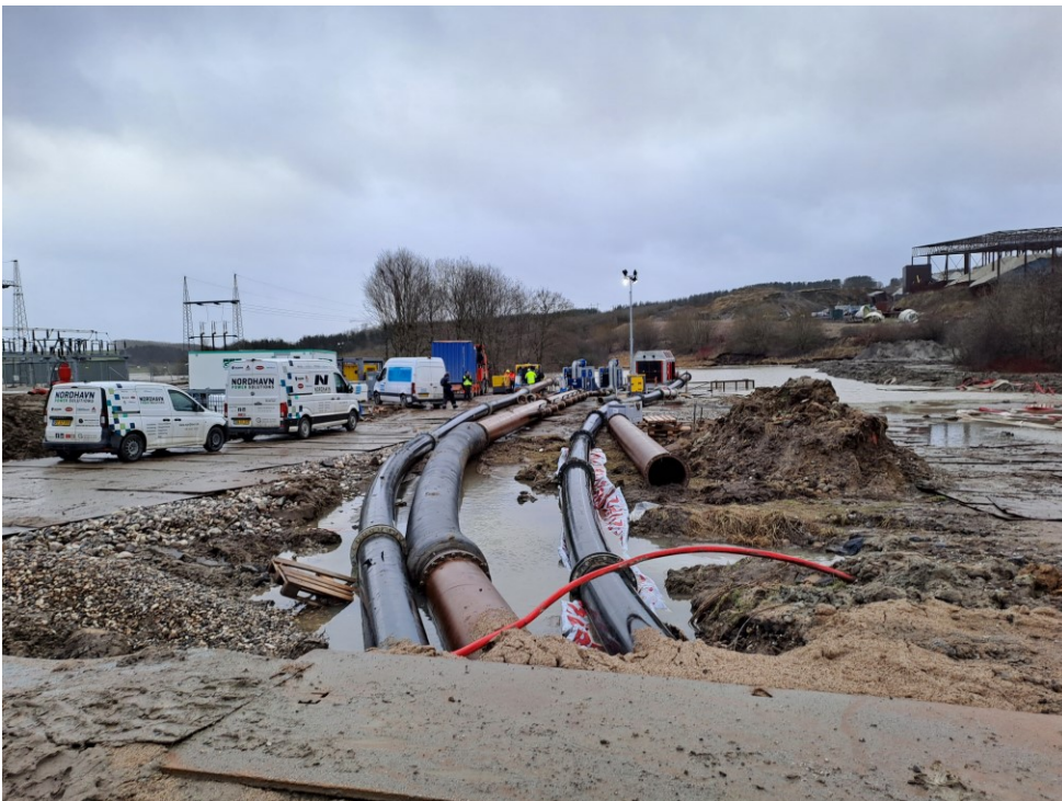
3 af de nuværende trykledninger for rent vand set fra landevejen med transformestationen til venstre
