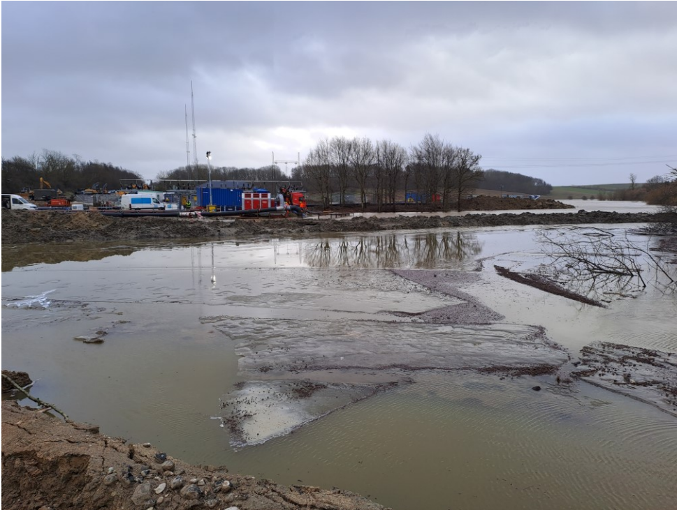
Forurenet vand nærmest – rent vand bagest – pumpestation i midten
