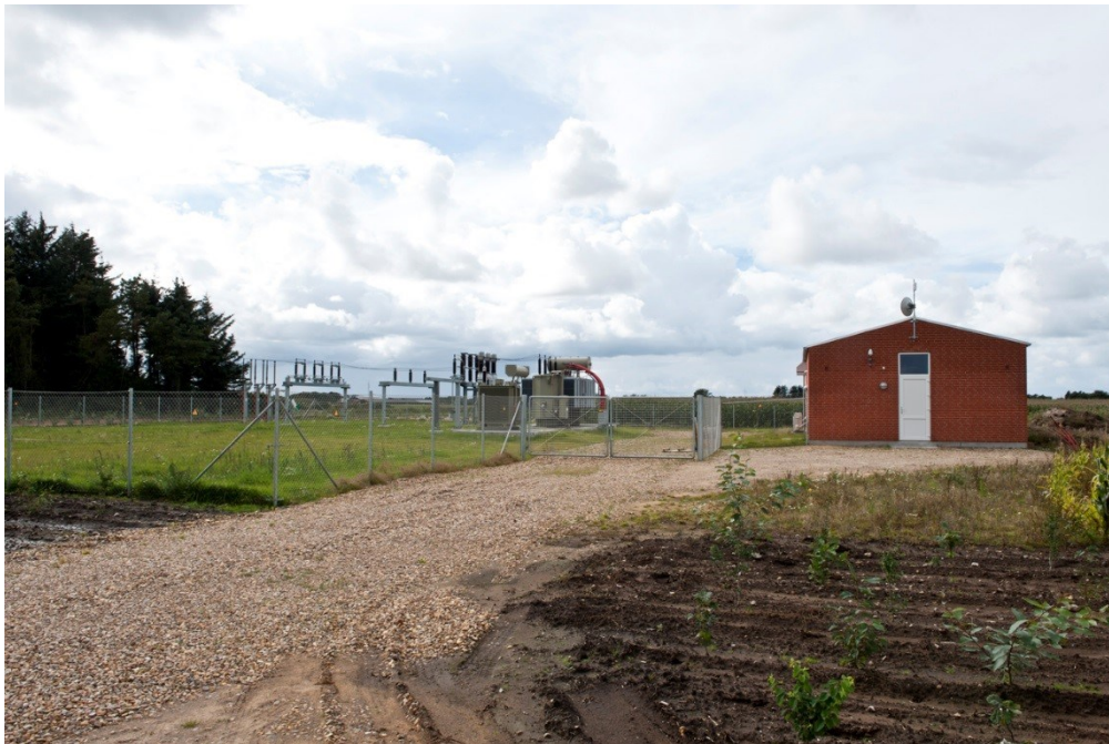
Figur 3.2. Nyanlagt transformerstation ved 30 MW vindmøllepark. Koblingsstationen ved Velling Mærsk vil være med eller uden transformator, som her ses til venstre for bygningen.
