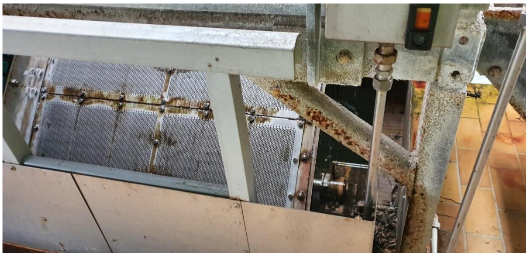
Figur 2-3. Billede af havvandsfilter i Renseværkbygningen.
