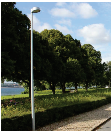
Figur 16 NYX 330 armatur påsat mast til belysning af kørebane og cykelsti med vifteformet lysspredning. Kilde COWI.
