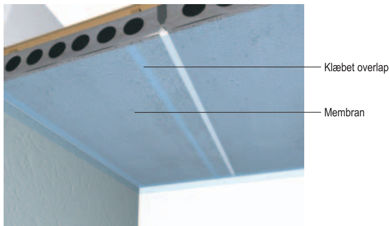
Figur 14. Baner af membranen klippes til så de samme længde som loftet. Pas på ikke at bøje eller krølle dem. Loftet påføres klæber i godt en banes bredde, og den første bane sættes op. Ca. 5 cm af den første bane og loft i en banes bredde påføres klæber, og anden bane sættes op, så de to baner overlapper med ca. 5 cm. Sådan fortsættes indtil den sidste bane, som skæres til i bredden, inden den sættes op. Der klippes omhyggeligt ud til eventuelle gennemføringer, så der kan blive overlap med strimlen der er klæbet på loftet ved gennemføringen.
