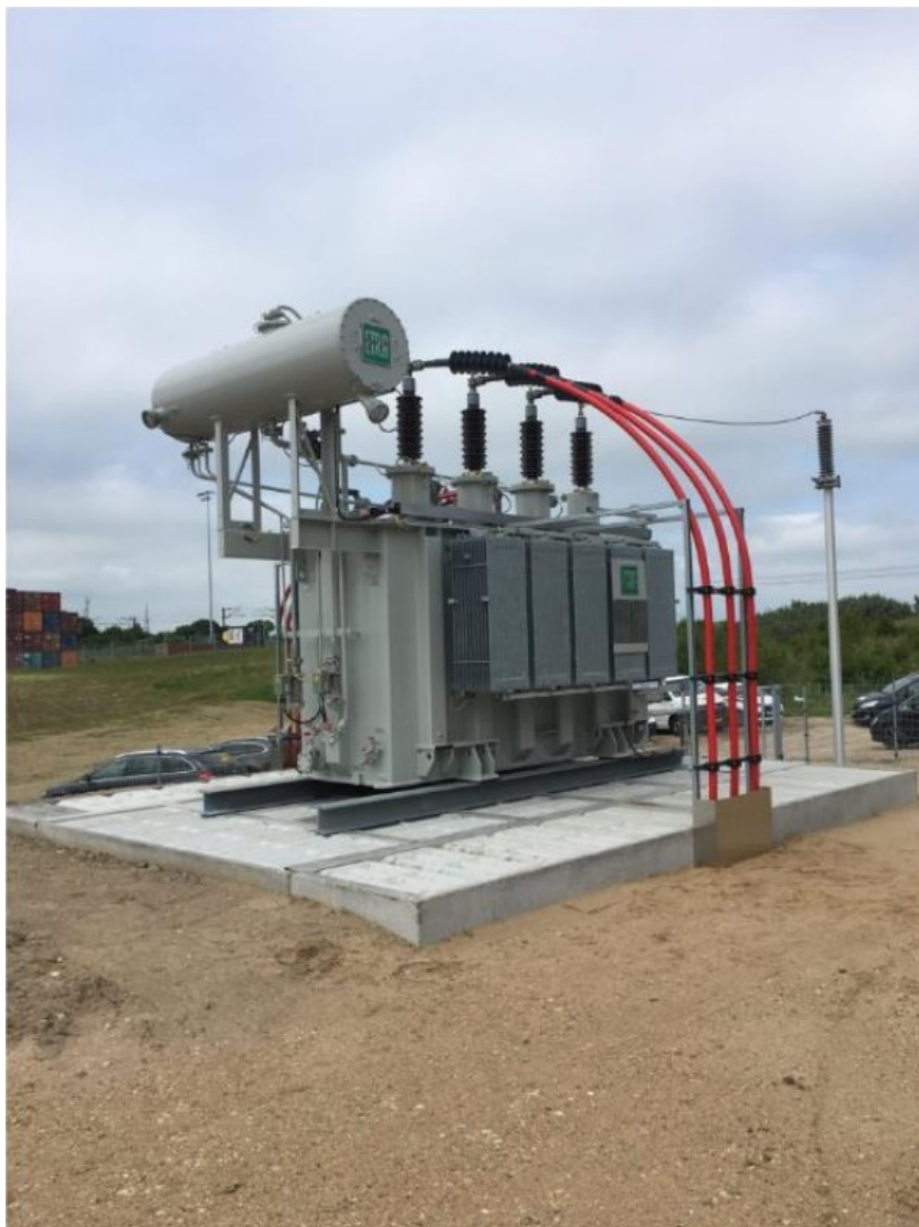
Figur 5: Eksempel på Transformer.
