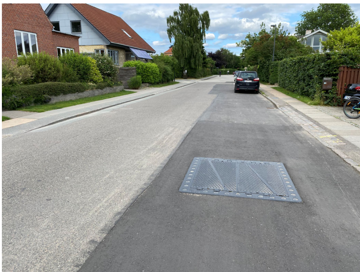
Figur 2-2: Linkboksbrønddæksel i vejareal.
