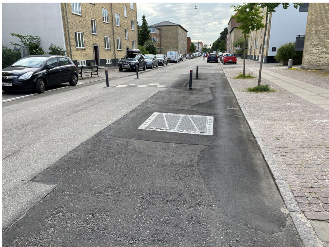
Figur 2-3: Linkboksbrønddæksel i vejareal.
