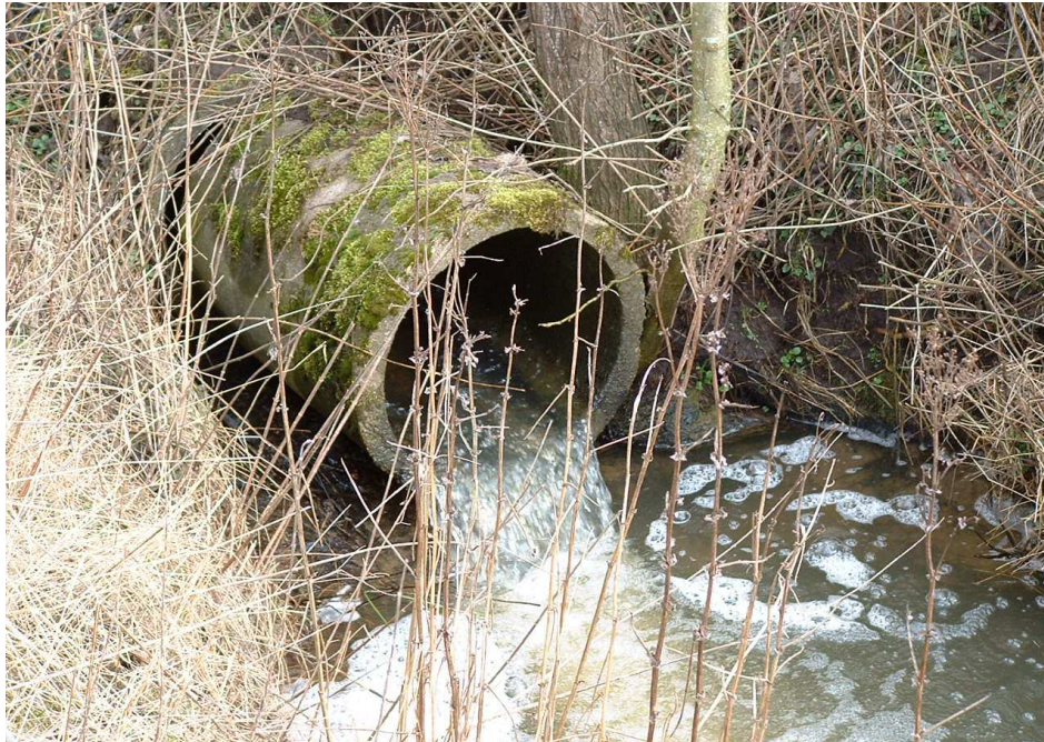
Overløb fra fælleskloak til Magtenbølleafløbet som er en del af Brende Å-systemet. Foto: Gunni Vilhelmsen.
