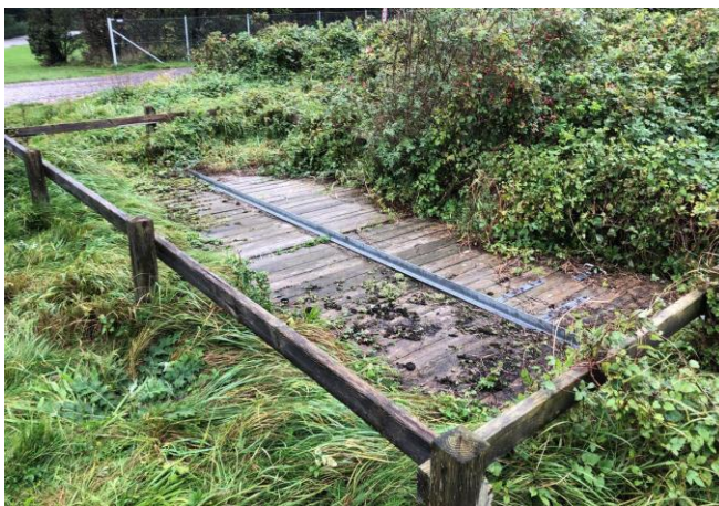
Figur 1 - Bygværkets placering og udseende. Dækket er af træplanker som er blevet møre og ikke længere stabile til færdsel. Rækværk er lavt og udgør ingen hindring i at færdes på bygværket. Midlertidig afspærring er sat op efter billede er taget.
