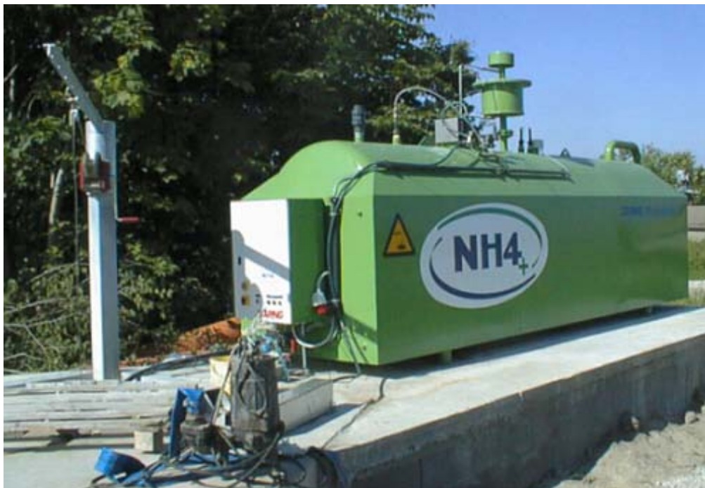
Figur 1 Tanken med svovlsyre kan rumme godt 5 tons koncentreret svovlsyre. Fra tanken kan svovlsyre doseres til bunden af fortanken, hvor også beluftningen finder sted
